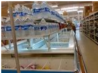
冷凍オープンケース
